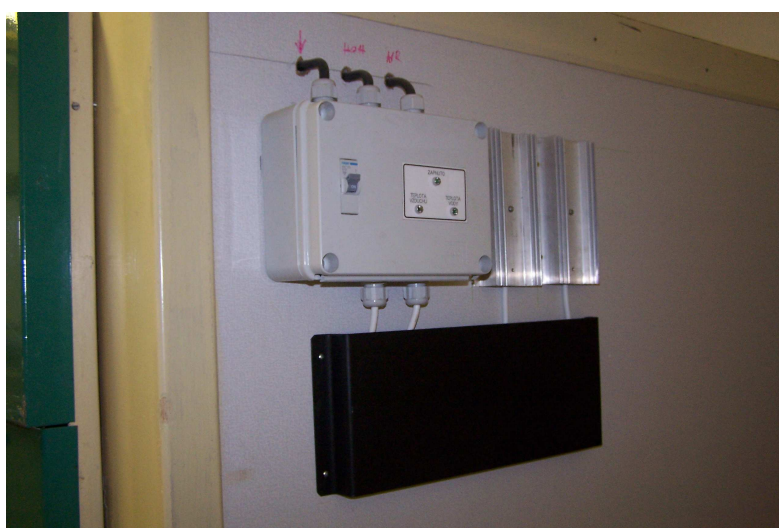
Obr. 41. Pohled na boční stěnu líhně s instalovanou stmívací jednotkou (vpravo od jednotky jsou zřetelné chladiče triaků).
