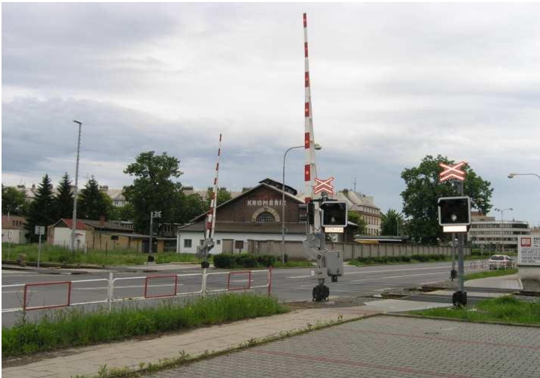
Obr. 8. Přejezd se světelnou signalizací a závory
