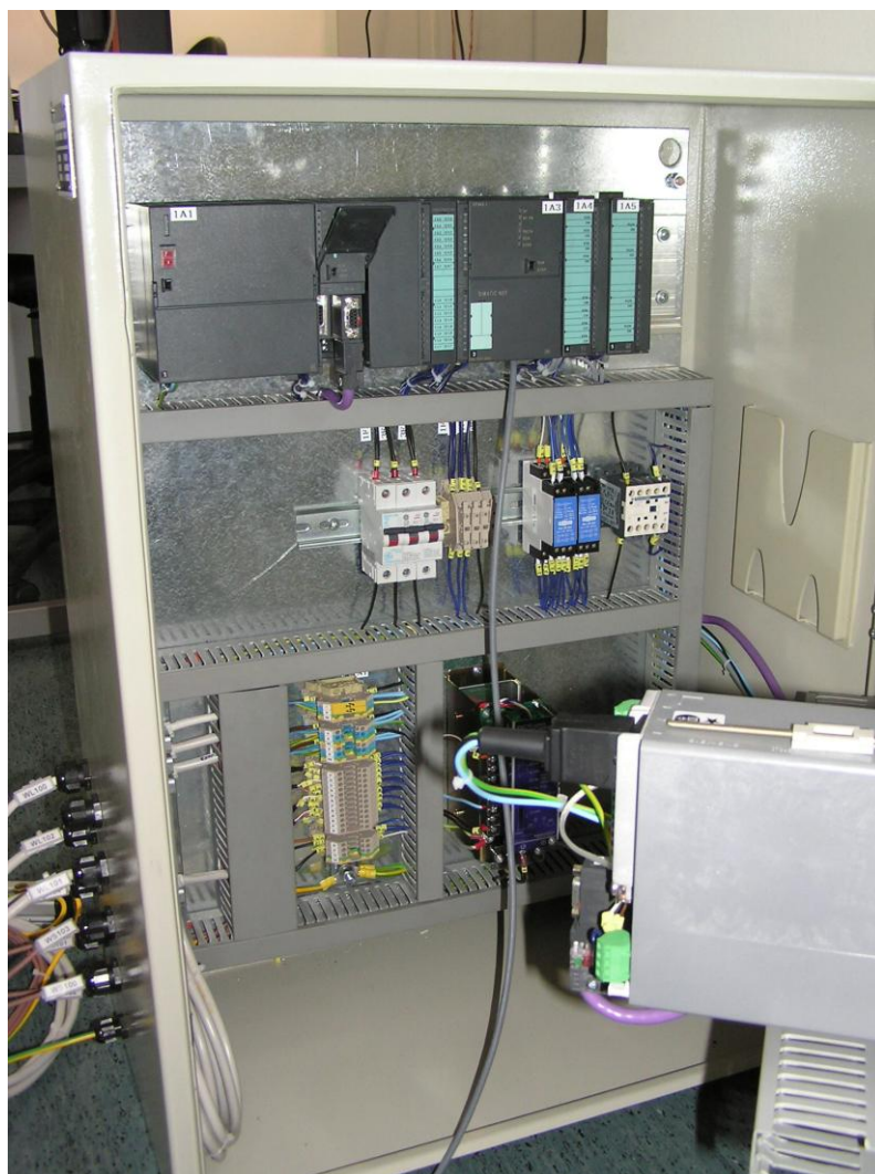
Obrázek 9. Rozvodná skříň úlohy DE1
