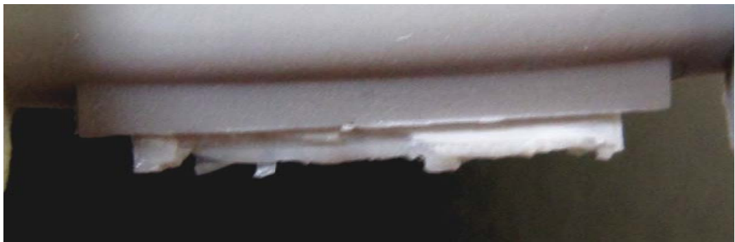
Obr.19 – Detail porušeného spoje - pohled B.
