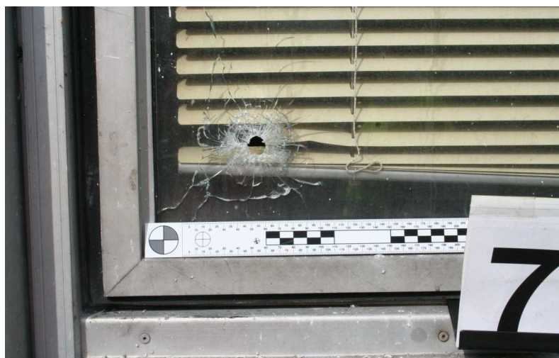
obrázek 8: Průstřel okna u nákladové rampy
