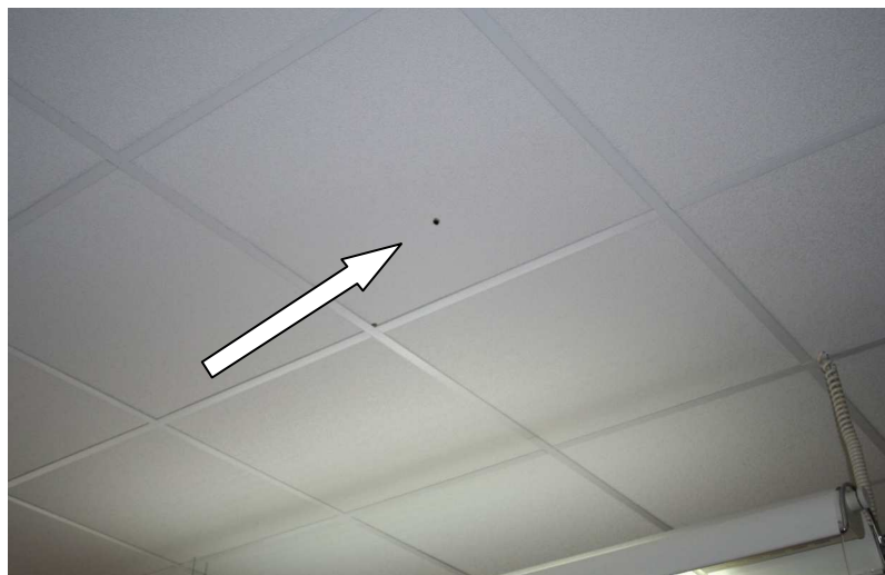
obrázek 9: Strop kanceláře, kde uvízla kulka po sebevražedném výstřelu
