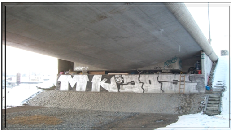
Foto č. 1 - pohled na ubytování bezdomovců pod silničním mostem v Brně na ul. Porgesova
