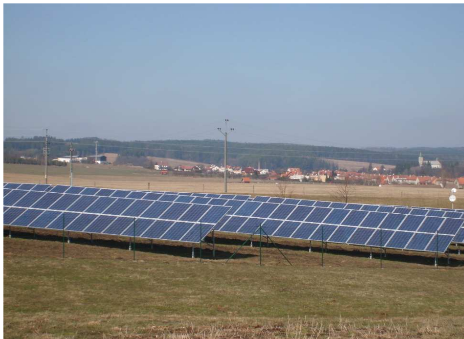
Obr. 13 Fotovoltaická elektrárna Slavičín ( Zdroj: vlastní )
