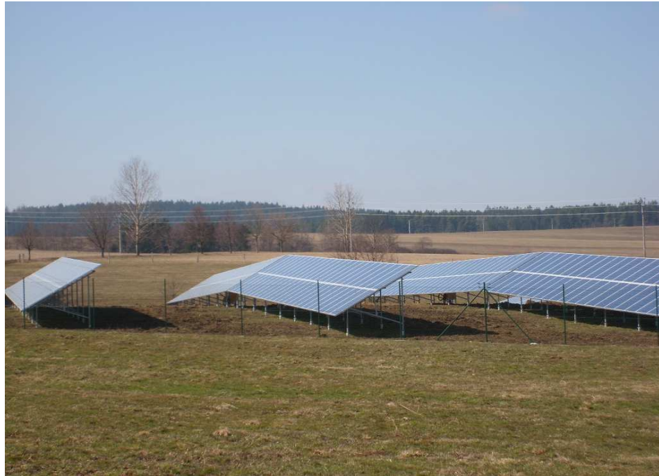
Obr. 14 Fotovoltaická elektrárna Slavičín ( Zdroj: vlastní )
