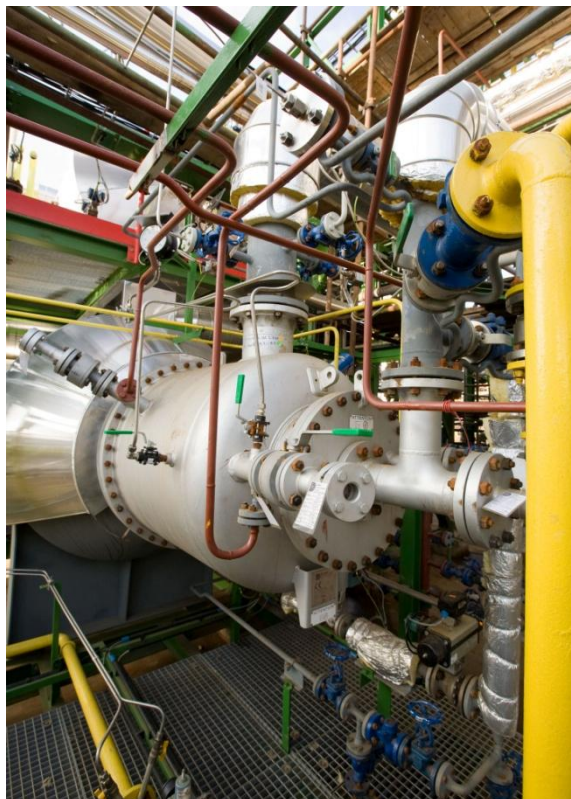
Obrázek 2 Pohled na hlavní spalovací komoru
