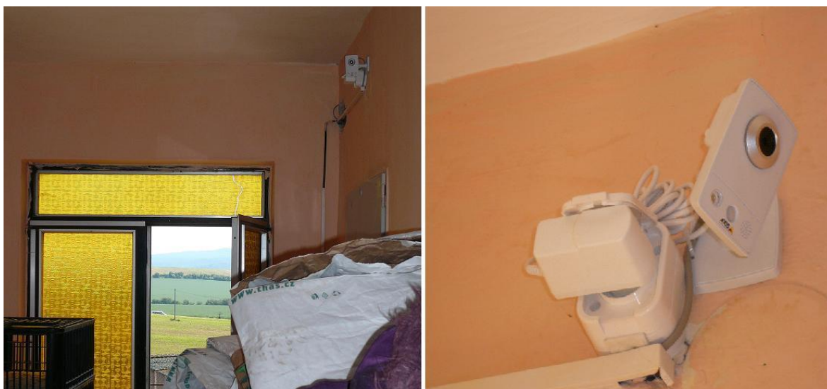
Obr. 39: Instalována kamera Axis M-1031 W
