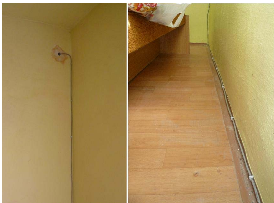
Obr. 40: Datový kabel k IP kameře
