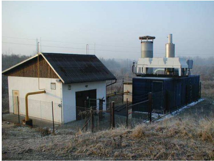
Obr. 6 Kogenerační jednotka na skládce Ozo Ostrava [8]
