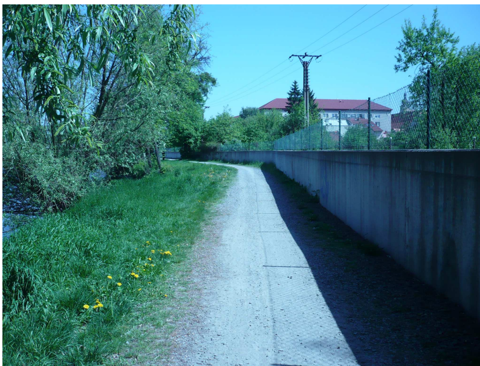
Obrázek 9: Betonová stěna v Napajedlích [Zdroj: vlastní]
