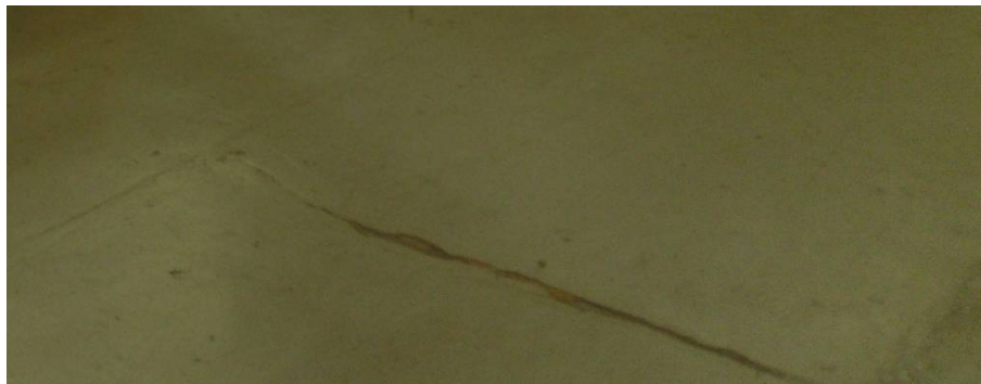
Obr. 19 Poškozená pracovní podlaha [vlastní zpracování]
