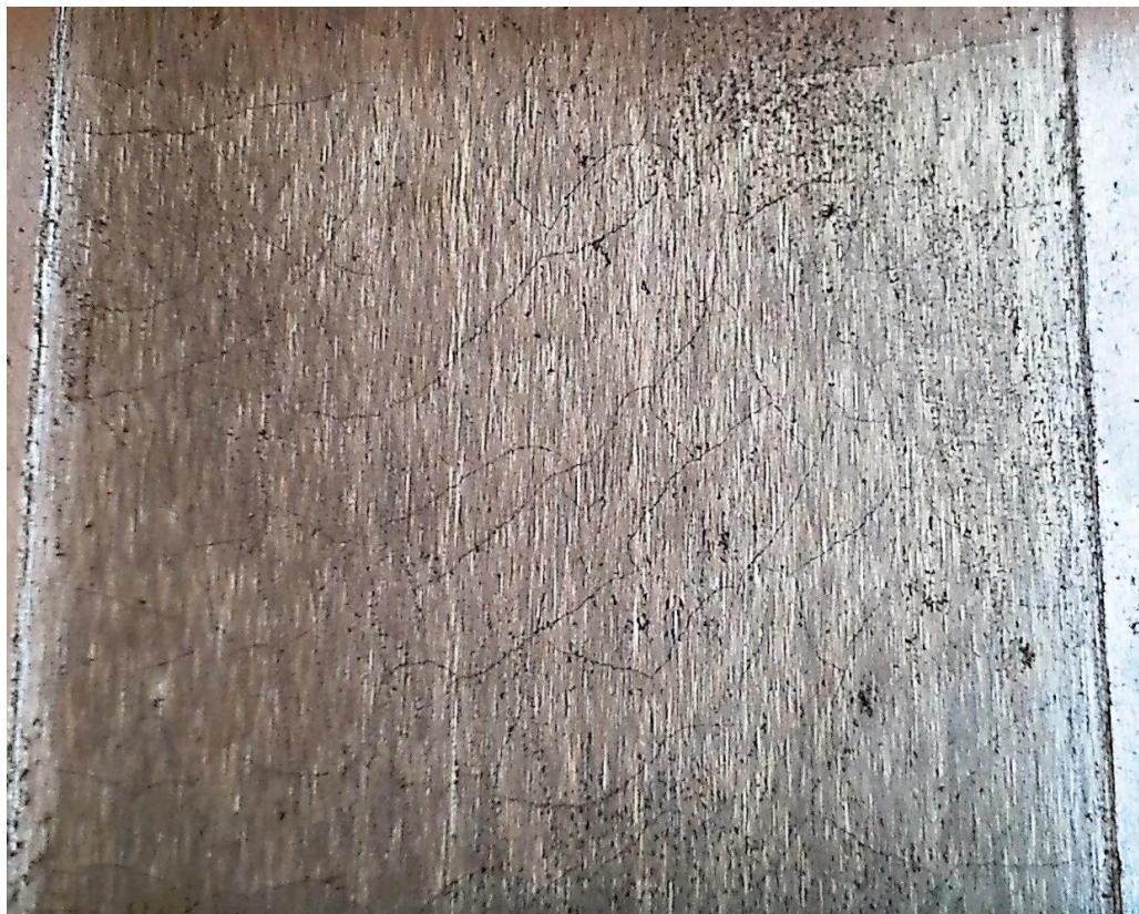
Obr. 29. Vzniklé sítě prasklin
