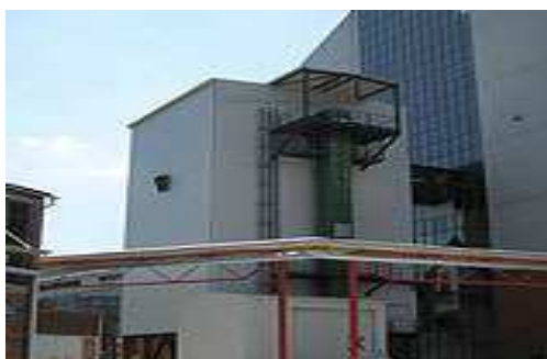
Obrázek 2 Kotelna s parním kotlem na biomasu [9]
