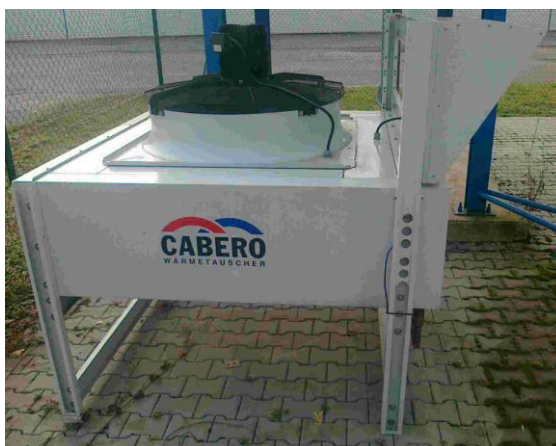
Obrázek 2 Kondenzátor chlazený vzduchem s nucenou cirkulací vzduchu
