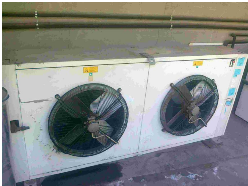
Obrázek 3 Kondenzátor chlazený vzduchem s nucenou cirkulací vzduchu
