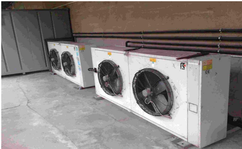
Obrázek 15 Kondenzátory chlazené vzduchem
