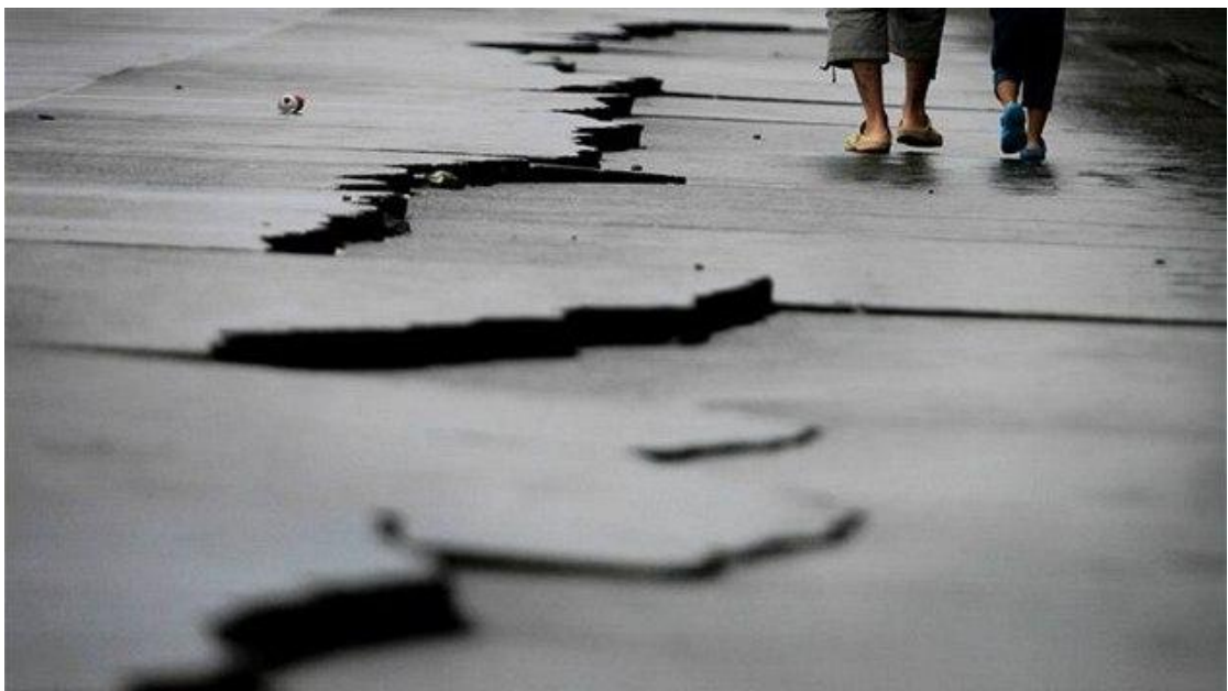
Obrázek 2: Detail na praskliny asfaltu po zemětřesení 2
