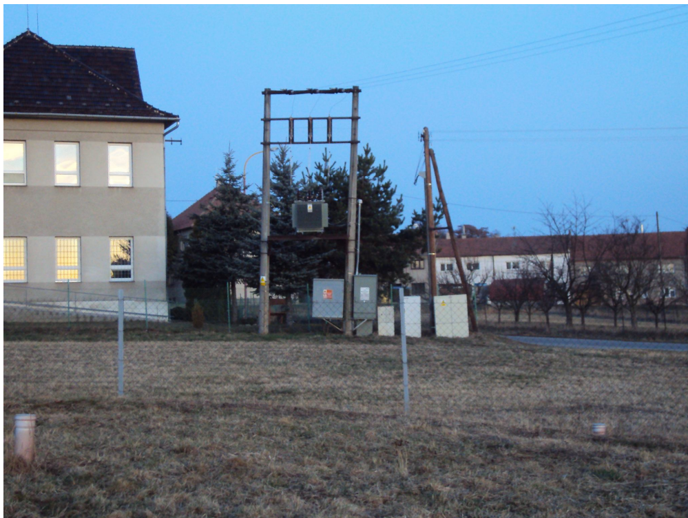
Obr. 8. Transformátor sluneční elektrárny
