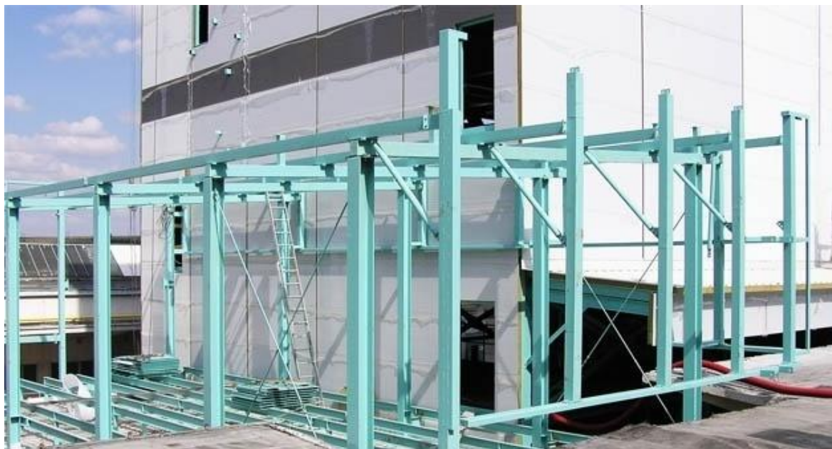
Obr. 6. Ocelová konstrukce trafostanice KORD KORDÁRNY ve Velké nad Veličkou (Výroba ocelových konstrukcí, © 2009)
