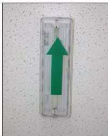
Obrázek 4 Detail nouzového osvětlení [30]
