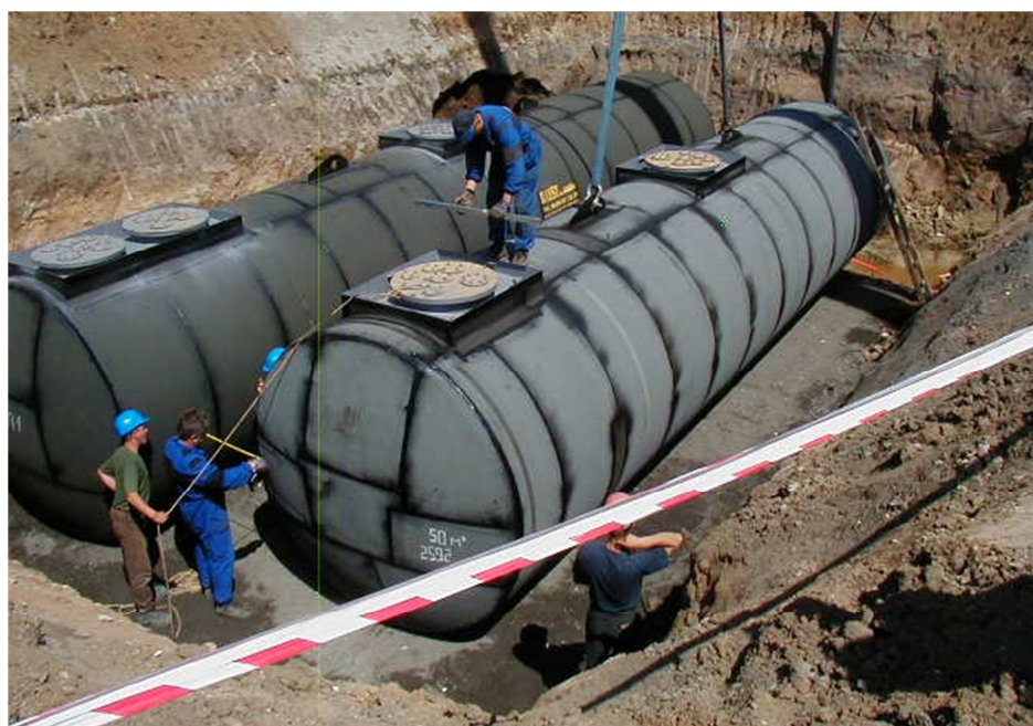
Obr. 4. Podzemní nádrže pro ukládání PHM. [14]
