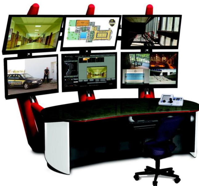
Obr. 5. Pult centralizované ochrany
