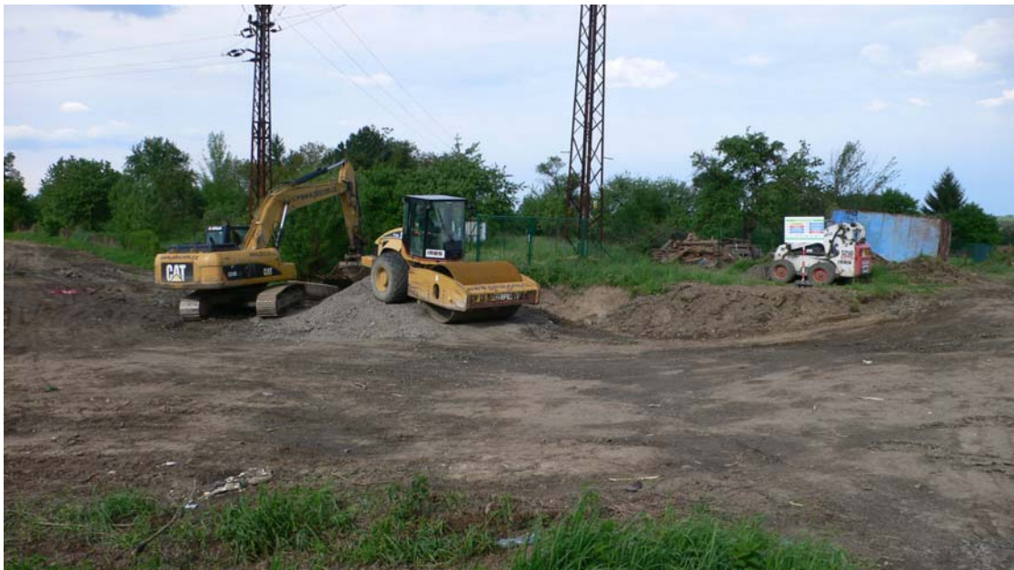
Obr. 33. Opuštěný vozový park k tvorbě protipovodňové hráze (Staré Město, 13. 5. 2013) [Zdroj vlastní]
