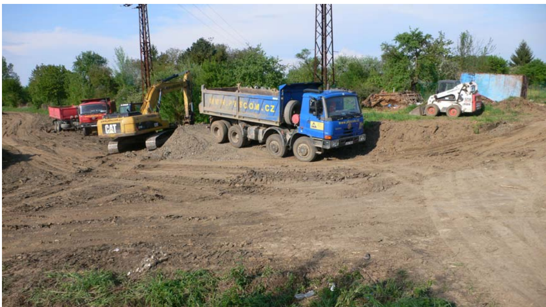
Obr. 34. Opuštěný vozový park k tvorbě protipovodňové hráze (Staré Město, 8. 5. 2013) [Zdroj vlastní]
