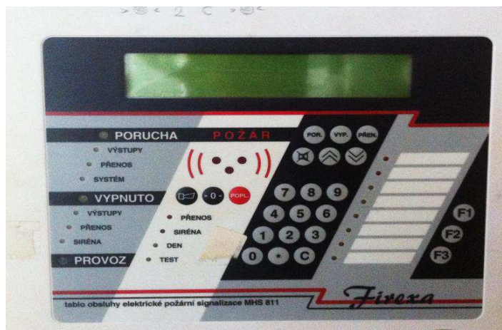
Obr. 25. Stávající stav požárně bezpečnostních zařízení - ústředna
