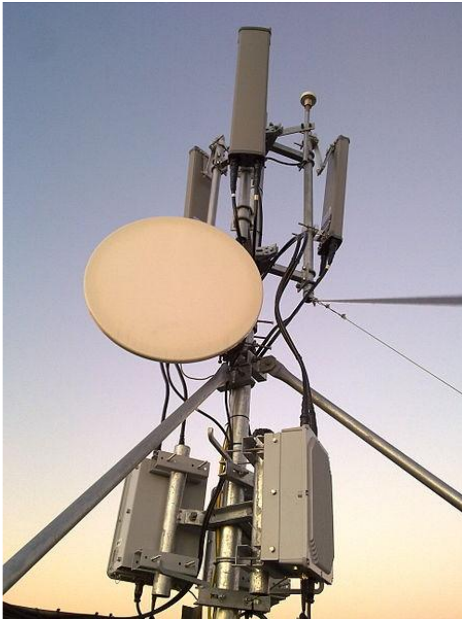
Obr. 3: Mobilní stanice WIMAX [11]
