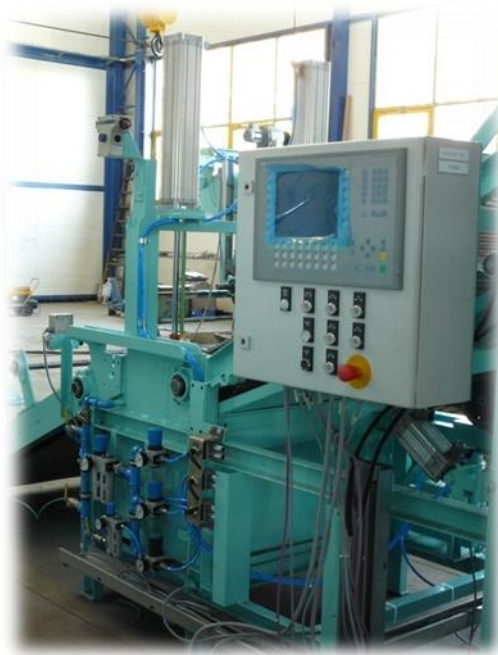
Obrázek 3 Výrobní linka vyráběná společností BUKO-S s.r.o. (Interní zdroj společnosti BUKO-S s.r.o.)
