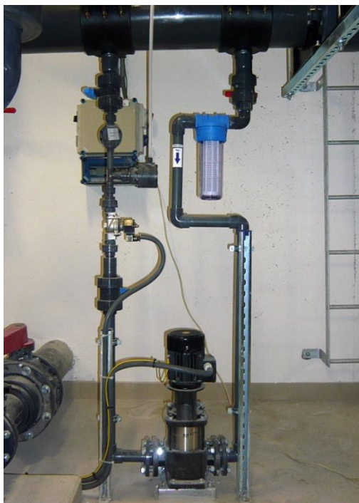
Obr. 7. Dávkování plynného Chloru do potrubí
