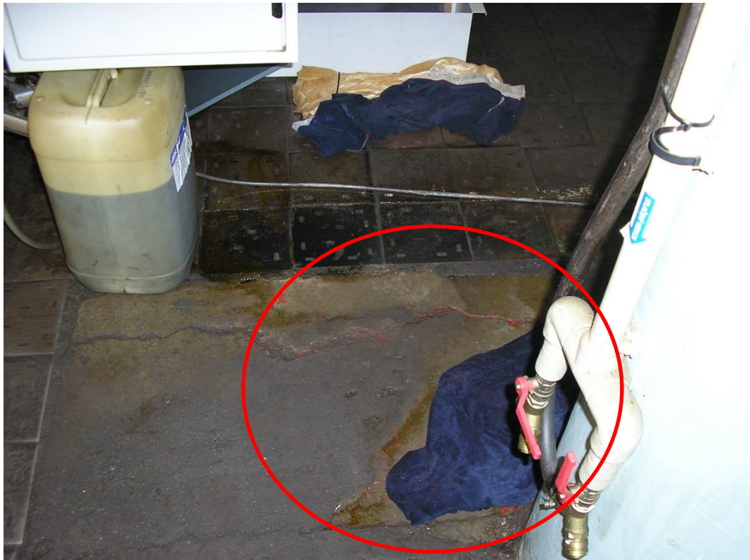
Obrázek 15 Stopy po kalužích kapalin vytékajících ze strojů (vlastní zpracování) Na zemi se vyskytují stopy po kalužích oleje, popřípadě dalších kapalin, které vytekly ze strojů.
