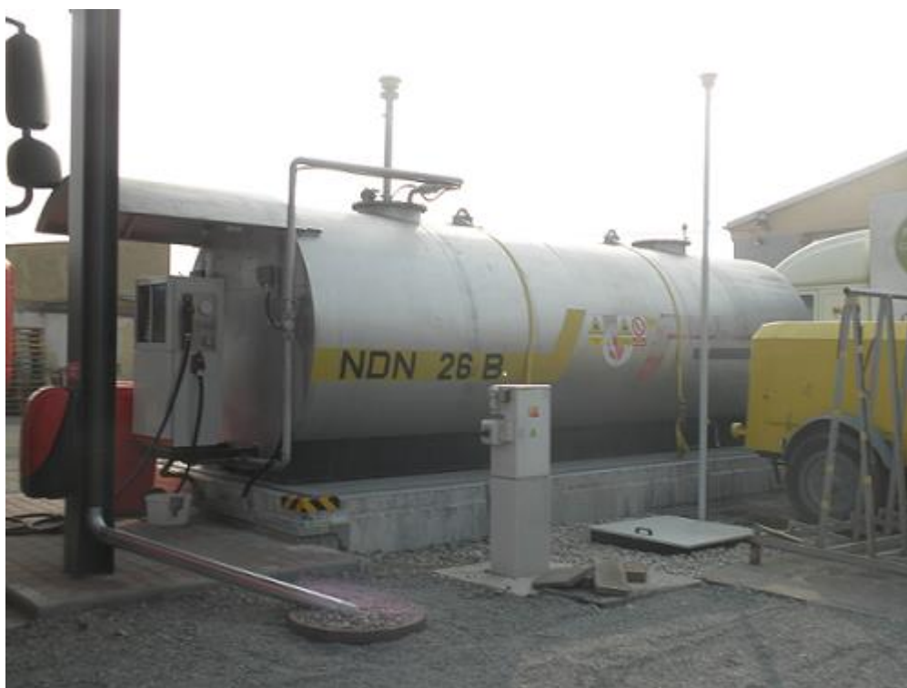
Obrázek 6: Nadzemní čerpací stanice NDN 26B
