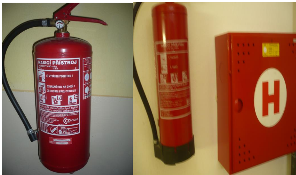
Obrázek 11 Hasicí přístroje a hydranty na ZŠ[zdroj vlastní]
