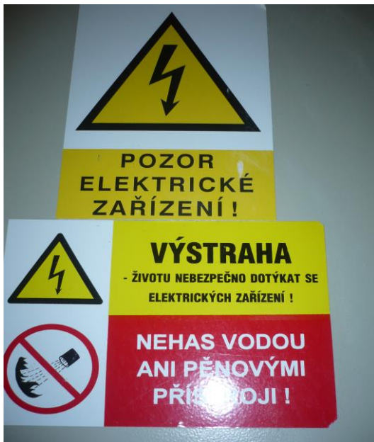
Obrázek 13 Elektrické rozvodné zařízení [zdroj vlastní]
