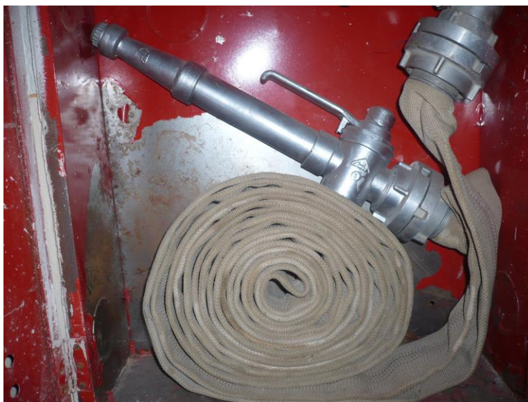
Obrázek 12 Hydrant na ZŠ [zdroj vlastní]
