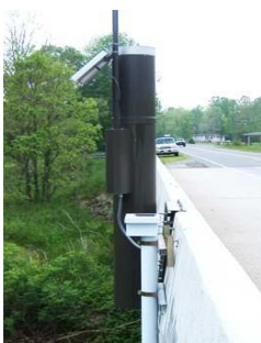
Obr.16 Měřicí jednotka systému IFLOWS
