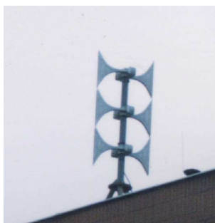
Obr. 5 Elektronická (mluvicí) siréna JSVV 3 [7]
