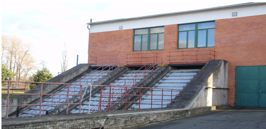
Obr. 11. Povodňová čerpací stanice. Zdroj: [vlastní]
