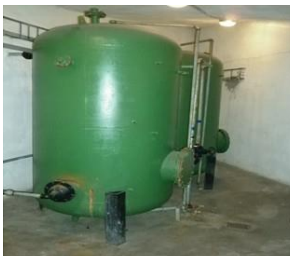
Místnost vodního hospodářství (vlastní zdroj)
