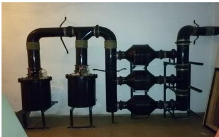
Filtroventilační zařízení (vlastní zdroj)
