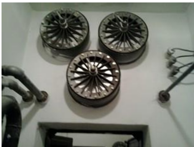
Tlakově plynotěsné uzávěry (vlastní zdroj)
