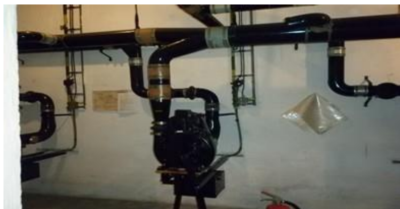
Ventilátorové agregáty – 2 (vlastní zdroj)
