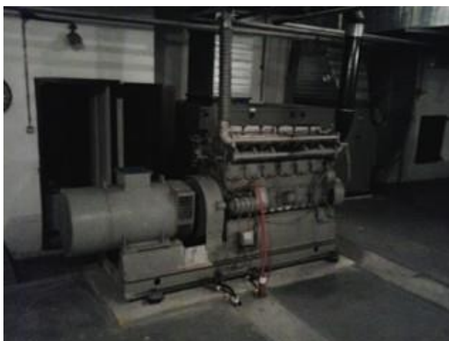
Náhradní zdroj elektrické energie – generátor (vlastní zdroj)
