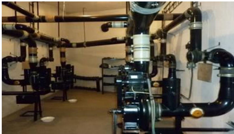
Ventilátorové agregáty – 1 (vlastní zdroj)
