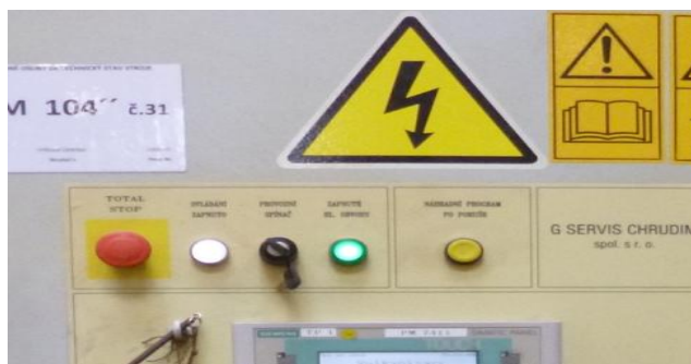
Obr. 18. Bezpečnostní značení „Pozor elektrické zařízení“ [vlastní zdroj].
