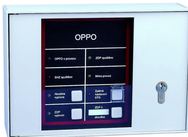
Obr. 23 Obslužné pole požární ochrany [8]
