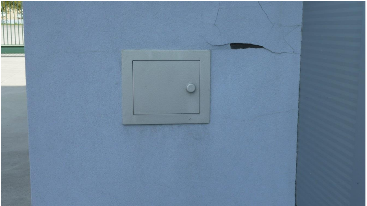
Obr. 37 Klíčový trezor požární ochrany
