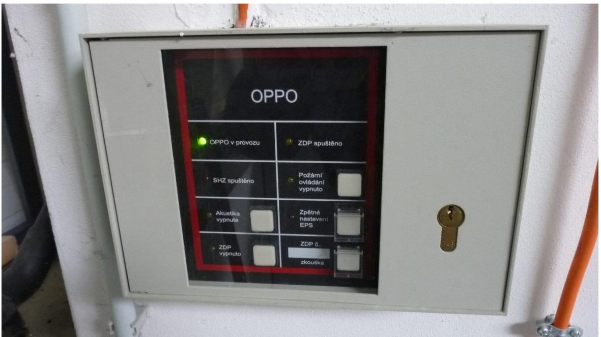
Obr. 38 Obslužné pole požární ochrany
