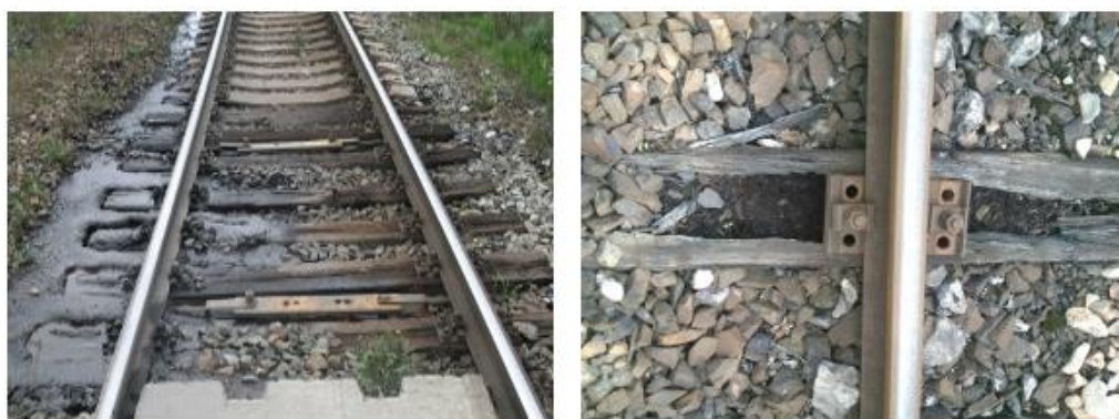
Obr. 3 Podmáčené kolejové lože a ukázka uhnitého pražce [18]
