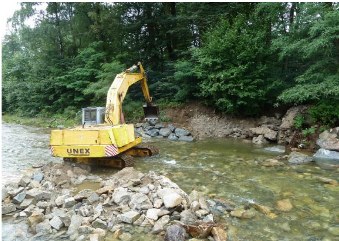
Obr. 11. Povodí Moravy odstraňuje škody po povodních [Zdroj: Pmo.cz]
