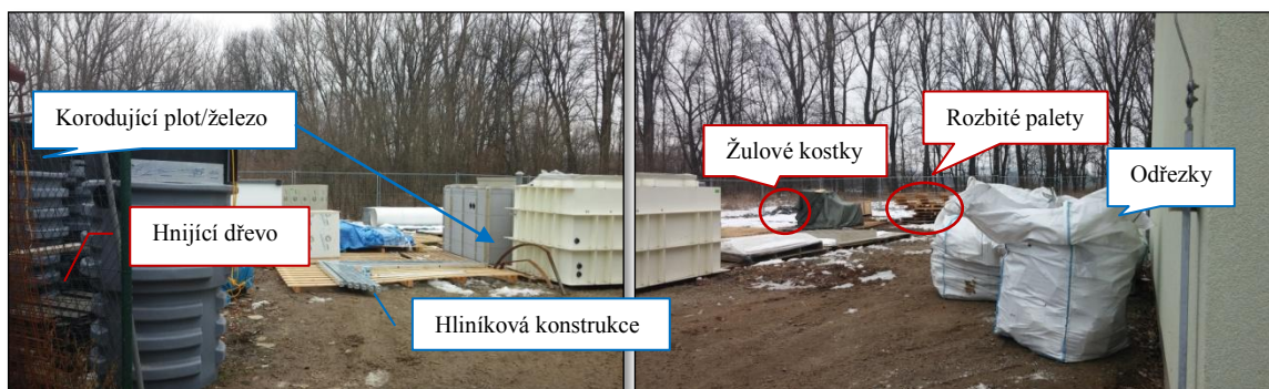
Obr. 48. Nevhodně zvolený terén pro uskladnění materiálu (Vlastní zpracování)
