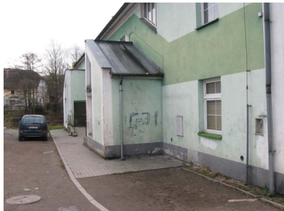
Obr. č. 9: Poničená fasáda domu (foto autor)
