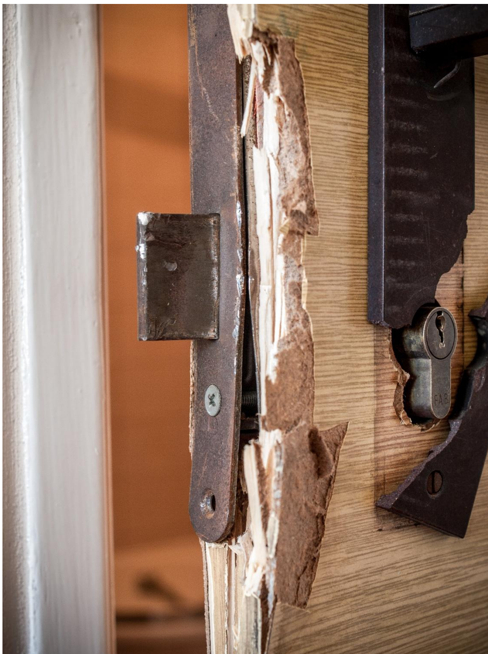
Obr. 28. Pohled na vypáčené dveře z vnitřní strany
