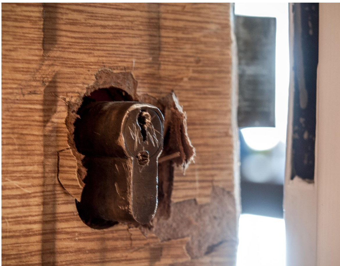
Obr. 20. Detail napadeného zámku
