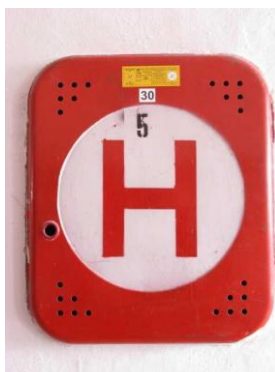
Obrázek č. 28 : Požární hydrant [archiv autora]
