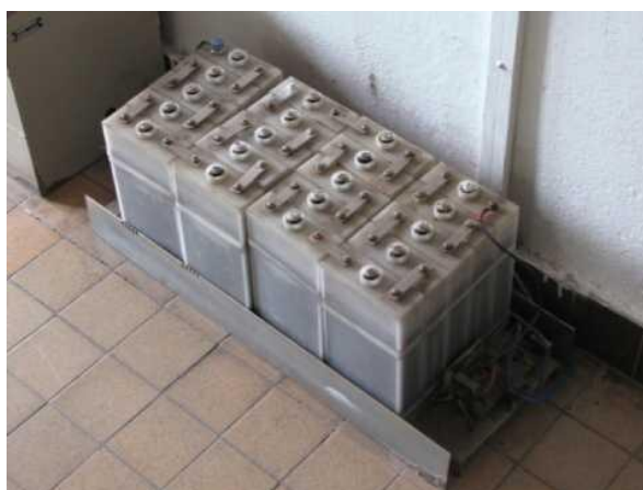
Obrázek č. 12.: Akumulátorová baterie, otevřená [archiv autora]
