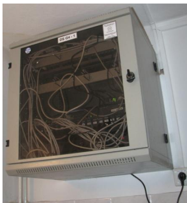
Obrázek č. 25 : Strukturovaná kabeláž [archiv autora]
