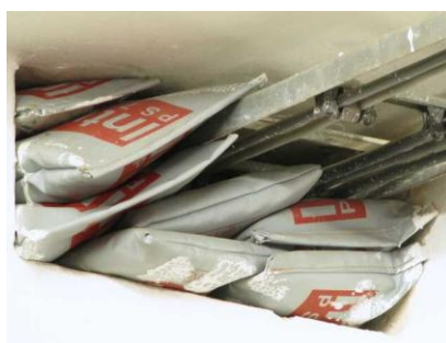
Obrázek č. 29 : Prostup skladovacích prostor Intumex PS [archiv autora]
