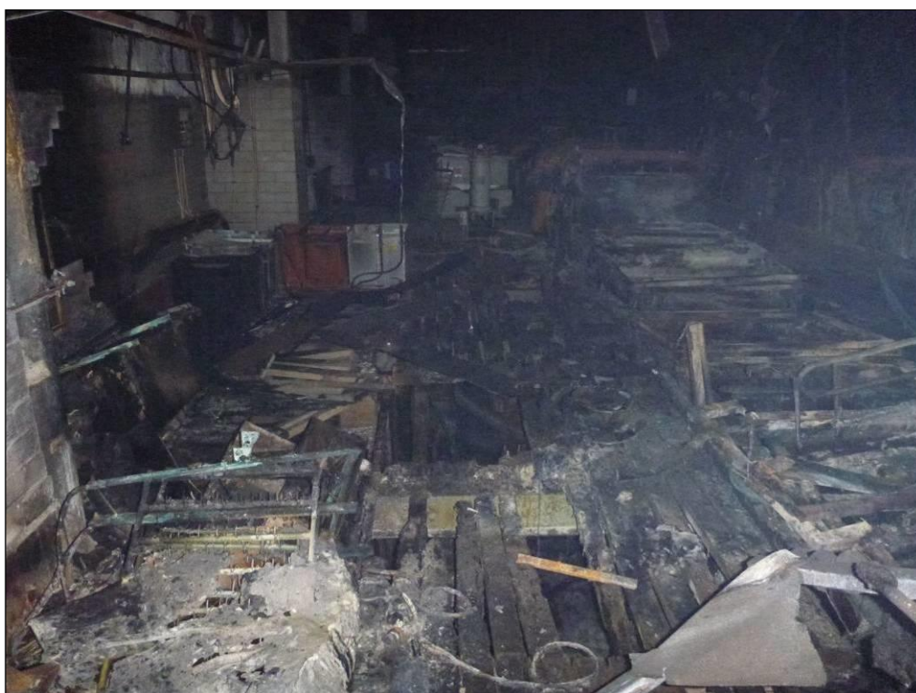
Místo vzniku požáru [27]
