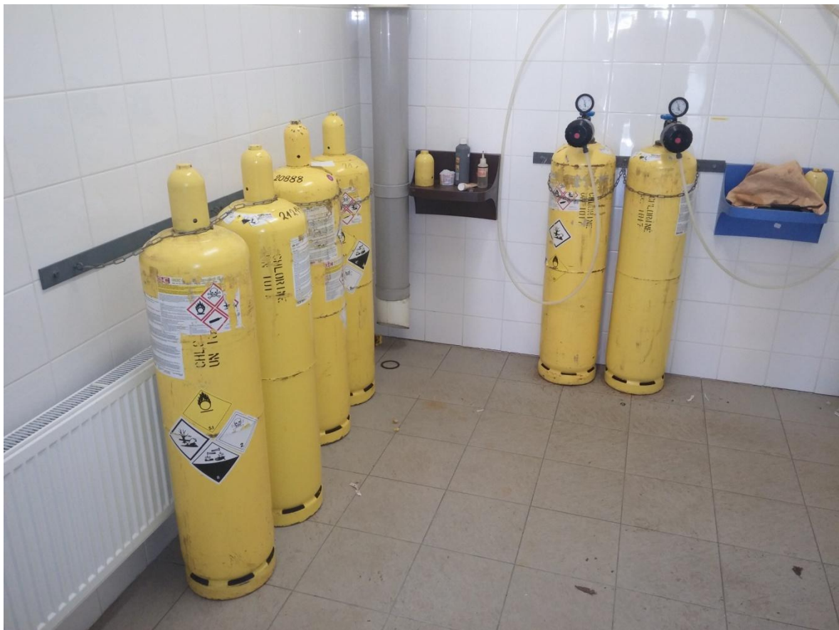
Obrázek 3 - Tlakové láhve umístěné v chlorovně [Zdroj: vlastní]
