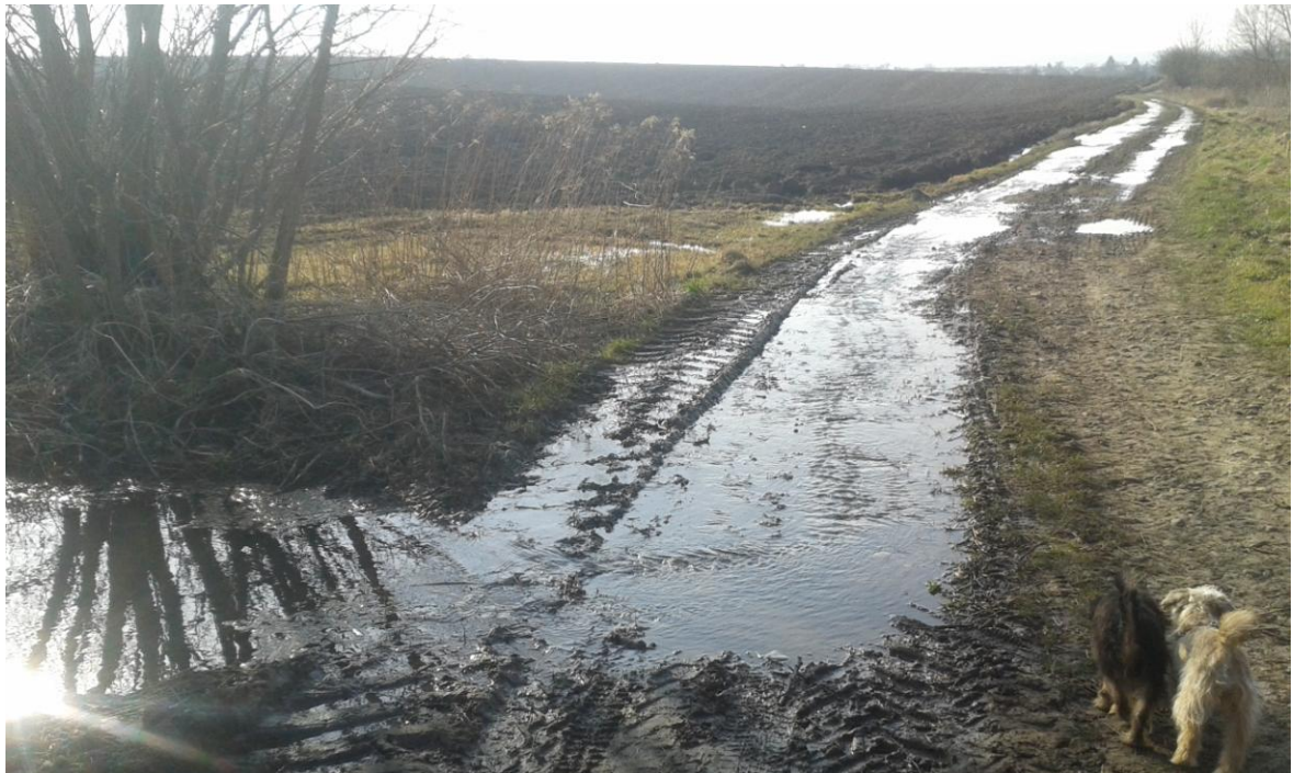
Ucpáný průtok potoka pod cestou
