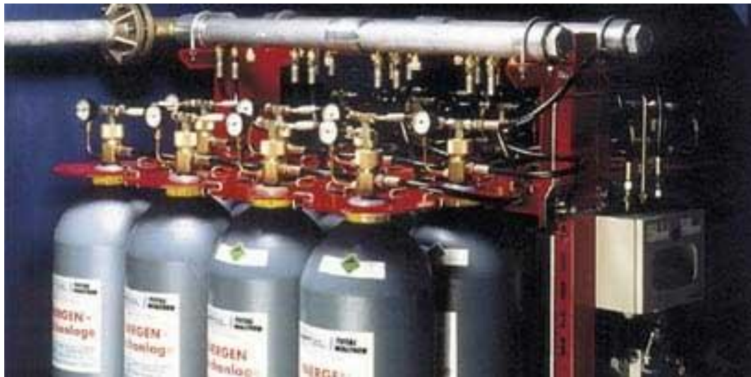
Obr. 36 Uskladnění a rozvod hasicího plynu
