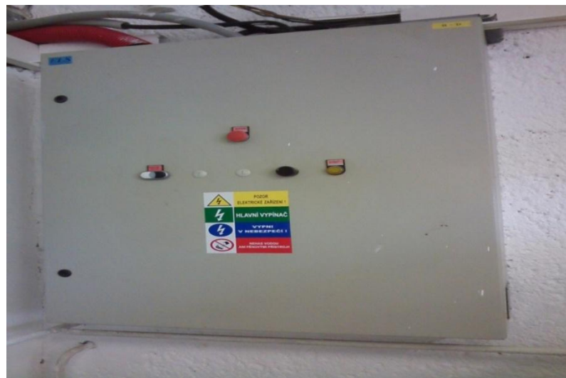
Obrázek 11: Ukázka bezpečnostního značení rozvodny elektřiny [Zdroj: Vlastní]
