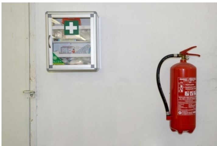
Obrázek 14: Lékárnička první pomoci a práškový hasicí přístroj [Zdroj: Vlastní]
