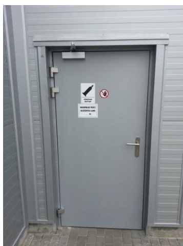
Obr. 15. Dveře – protipožární [vlastní zpracování]
