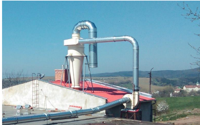
Obr. 12. Filtrační zařízení (vlastní)
