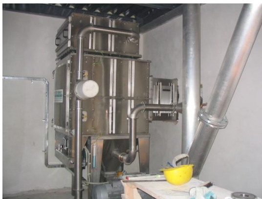
Obr. 4. Filtrační zařízení namontované v daném provozu (vlastní)
