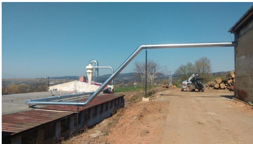
Obr. 11. Venkovní vedení filtračního zařízení (vlastní)
