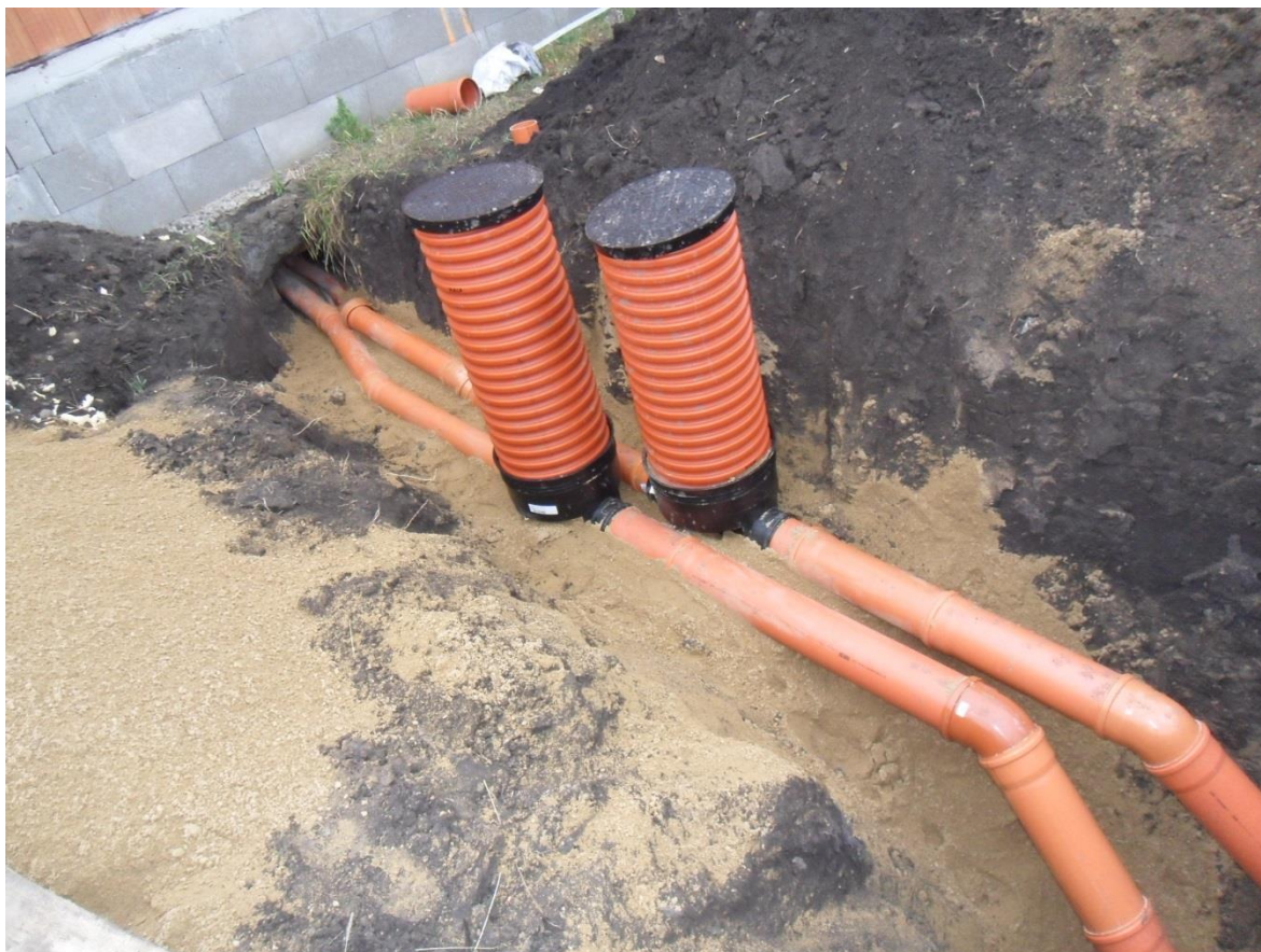
Obr. 10: Kanalizační přípojka PVC 150 mm a revizní kanalizační šachta DN 400 mm (zdroj: vlastní)
