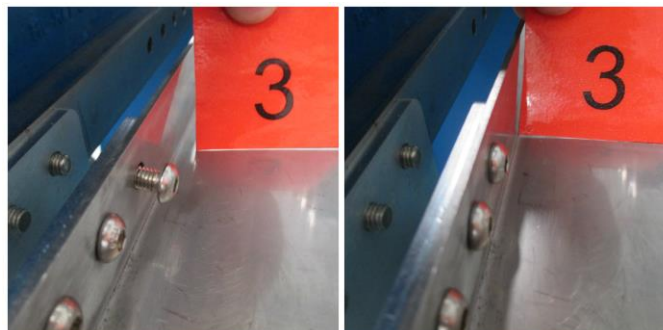
Obrázok 37: Počiatočné čistenie - uvoľnené skrutky. Situácia pred a po odstránení problému. (Zdroj: vlastné spracovanie)
