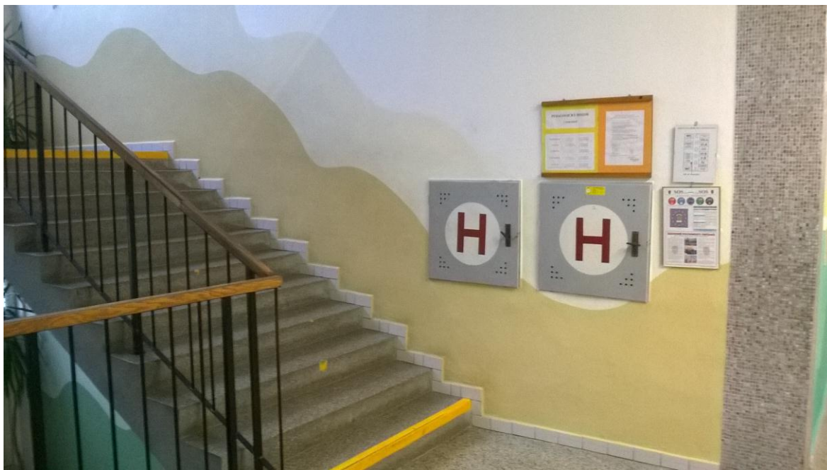
Obrázek 10 Nástěnné hydranty u schodiště [26]
